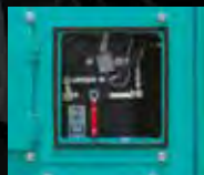
Valvola manuale di emergenza per l'abbassamento cabina
